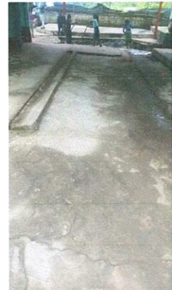
Foto 4: Necesidad de reparación de losa de patio
